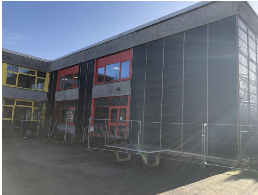
Demontage Attika-Fassadenplatten inkl. KMF-Dämmung Restdemontage Fassadenplatten inkl. KMF-Dämmung Demontage provisorische KMF-Dämmung inkl. Lattung u. Folie
