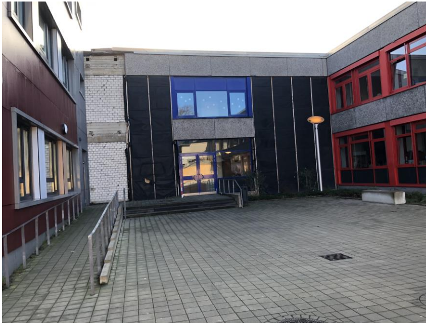
Demontage Attika-Fassadenplatten inkl. KMF-Dämmung Restdemontage Fassadenplatten inkl. KMF-Dämmung Demontage provisorische KMF-Dämmung inkl. Lattung u. Folie
