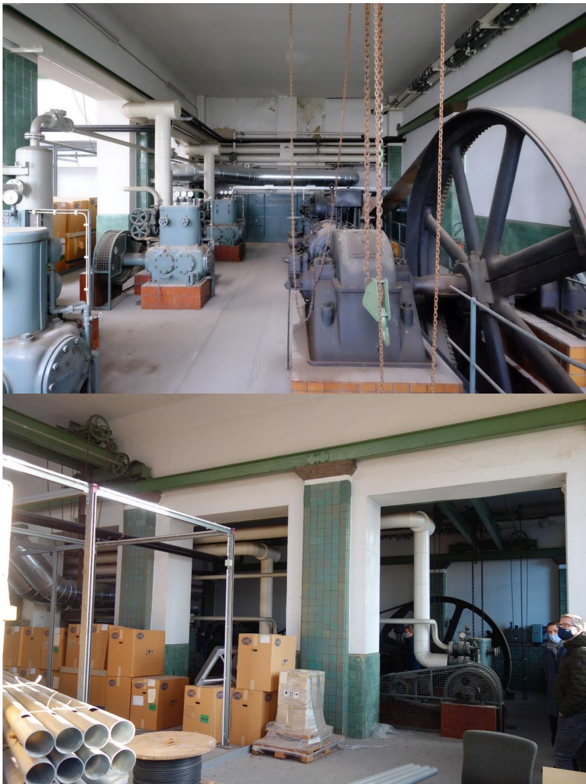
Mülheim an der Ruhr, Wissollstraße 10/Ulmenallee, Kraftzentrale des ehem. städtischen Schlachthofes, Innenansicht des Maschinenhauses, Details der Wandgestaltung und Kranbahn, Foto: Nadja Fröhlich, LVR-ADR, 2021.
