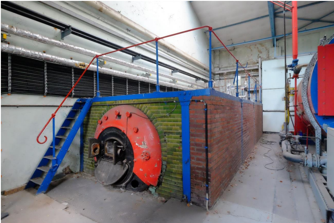
Mülheim an der Ruhr, Wissollstraße 10/Ulmenallee, Kraftzentrale des ehem. städtischen Schlachthofes, Innenansicht mit Kessel, Foto: Rasmus Radach, LVR-ADR, 2021.
