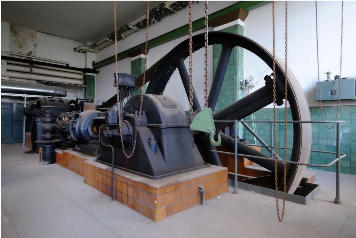
Mülheim an der Ruhr, Wissollstraße 10/Ulmenallee, Kraftzentrale des ehem. städtischen Schlachthofes, Innenansicht des Kondensator- und Kompressorgebäudes mit Ausstattung, Fotos: Rasmus Radach, LVR-ADR, 2021.
