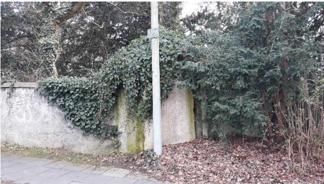
Einfriedung im Norden und Westen überwiegend aus hohen verputzten Ziegelmauern, an der nordwestlichen Ecke des Anwesens ein Eckpavillon mit Kuppel, dessen Türöffnung derzeit außen zugesetzt ist, davor eine für das historische Erscheinungsbild abträgliche Mastleuchte
